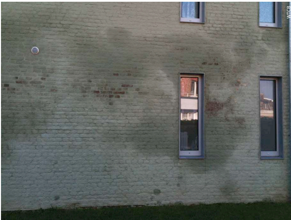
Afb. 6 Vochtigheid die niet te wijten is aan capillariteit vanuit de bodem: deze grote vlek met een onregelmatige vorm wordt wellicht veroorzaakt door de aanwezigheid van nitraten in het metselwerk.
