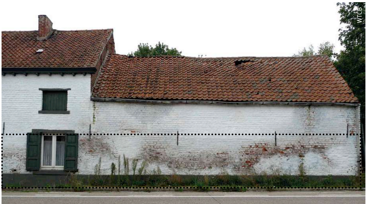
Afb. 3 Opstijgend vocht (omkaderd met een zwarte stippellijn): deze muur is niet uitgerust met een waterkerend membraan aan de muurvoet en heeft het grondwater opgenomen over een hoogte van een meter.
